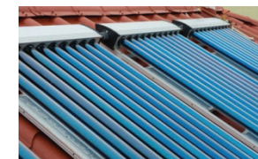
SOLARNI KOLEKTORI ZA PROIZVODNJU TOPLE VODE
